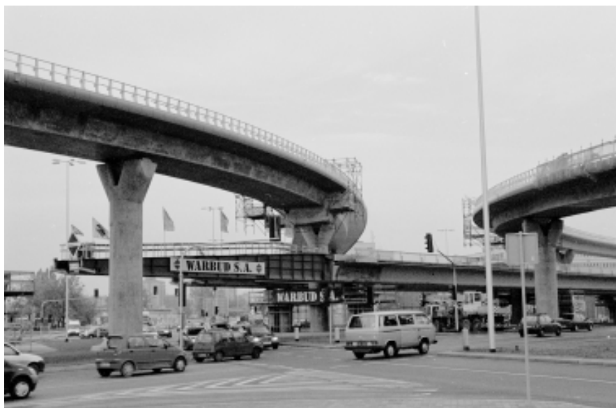
Prowadzenie prac budowa Trasy Siekierkowskiej pomimo wyroku NSA o cofnięciu pozwolenia na budowę, Warszawa
